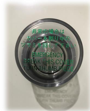
(写真 2) 非常時ロック解除カバー
